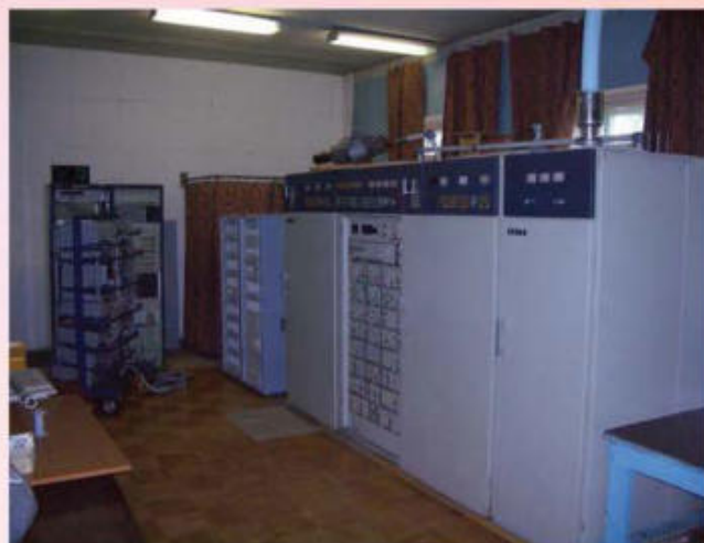
Цех УКВ, аппаратный зал ТВ станции «Зона-2», Кемерово
