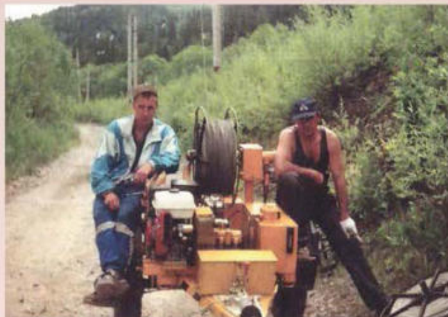
Прокладка и монтаж ВОЛС по опорам контактных сетей железнодорожного транспорта. Г. А. Соломин, Б. Ф. Петров. Участок Барнаул – Рубцовск, Кемеровское СМУ, 2001 г.
