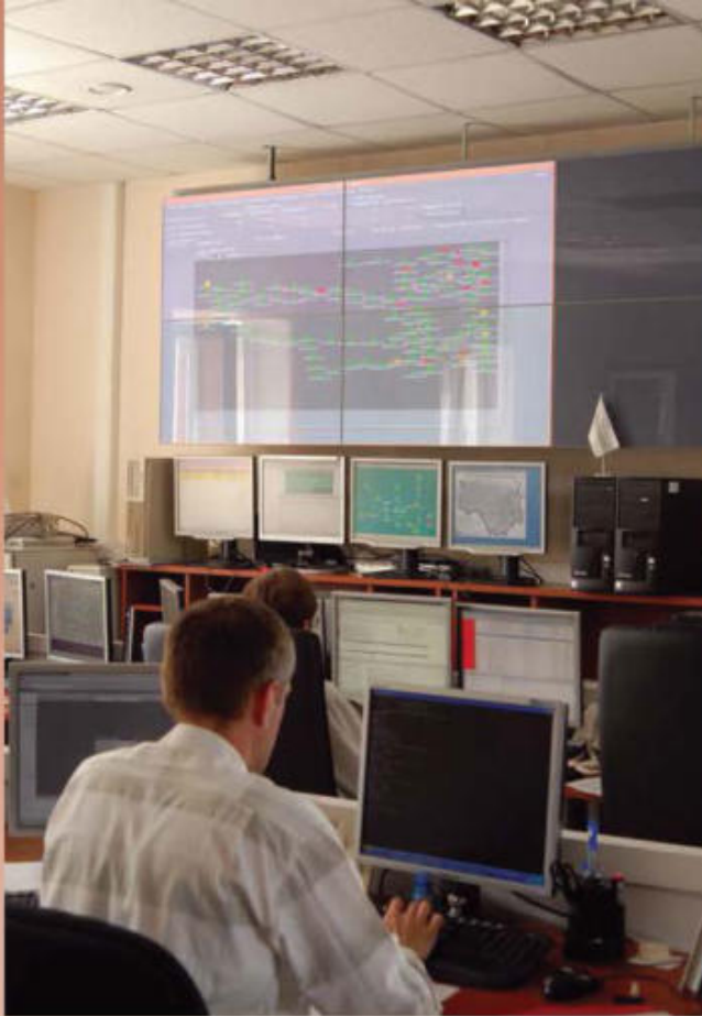
Отдел оперативного управления сетями работает круглосуточно
