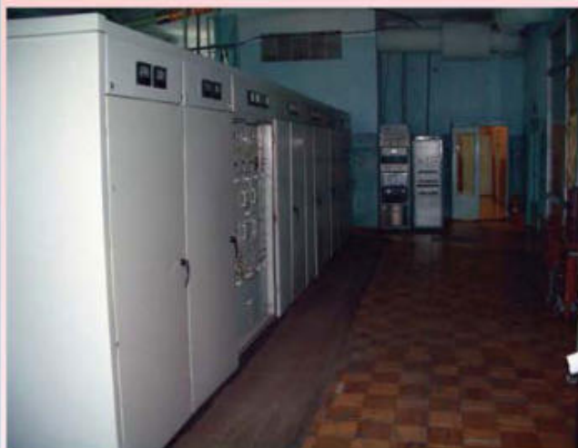
Телевизионный передатчик ДМВ диапазона «Ильмень» мощностью 20 кВт, Анжеро-Судженск
