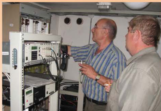
Реконструкция сети радиосвязи
