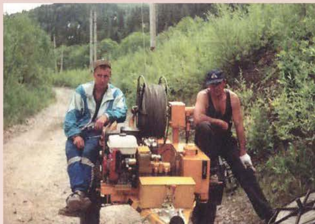
Прокладка и монтаж ВОЛС по опорам контактных сетей железнодорожного транспорта. Г. А. Соломин, Б. Ф. Петров. Участок Барнаул – Рубцовск. Кемеровское СМУ. 2001 г.
