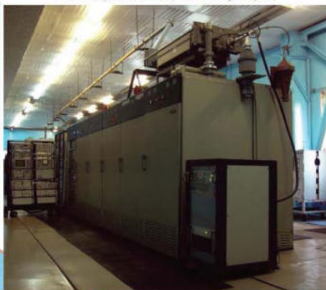
ТВ-передатчик ДМВ диапазона TV-20 мощностью 20 кВт, Ленинск-Кузнецкий
