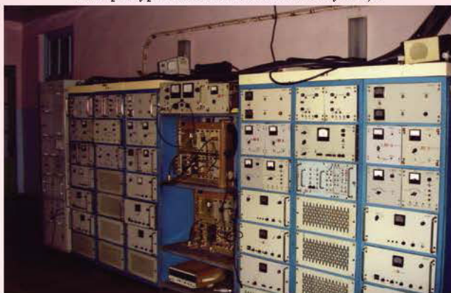
Передающее оборудование РЦТА-70-Р12, пос. Мундыбаши
