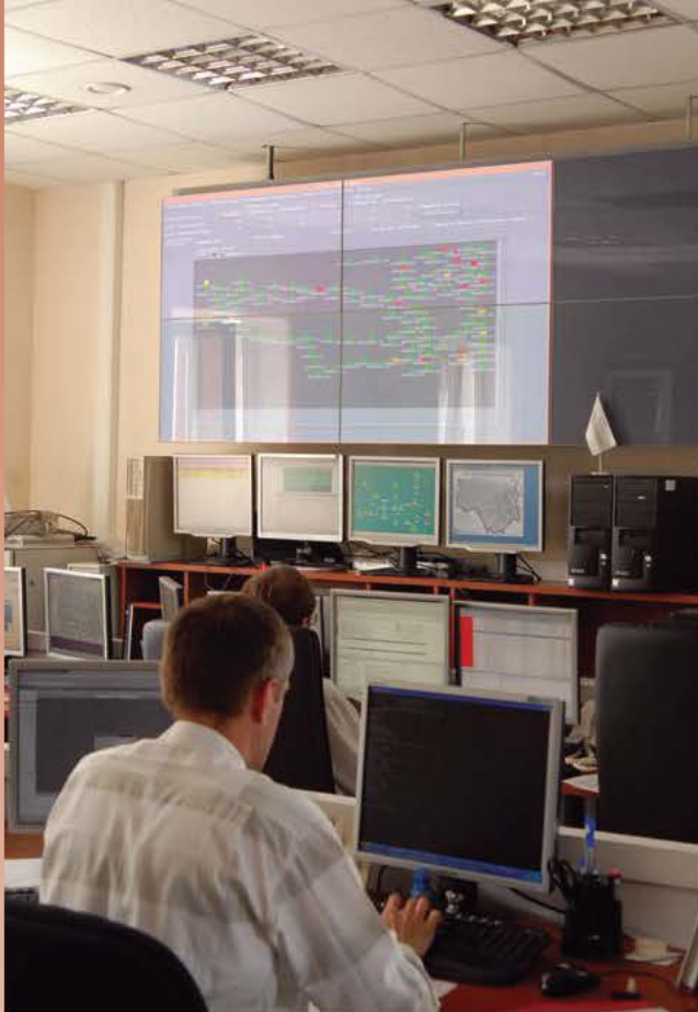
Отдел оперативного управления сетями работает круглосуточно
